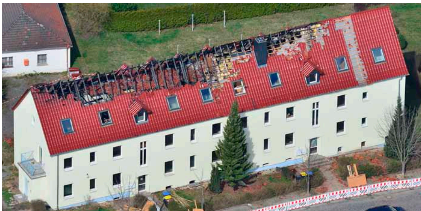
centro di accoglienza danneggiato da un incendio doloso
